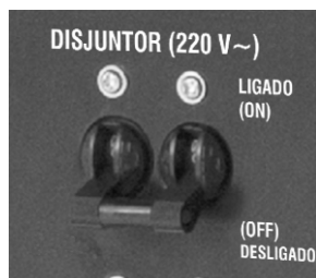
Figura 13 – Disjuntor do Circuito CA
